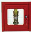
POSTE DE DÉTENTE
